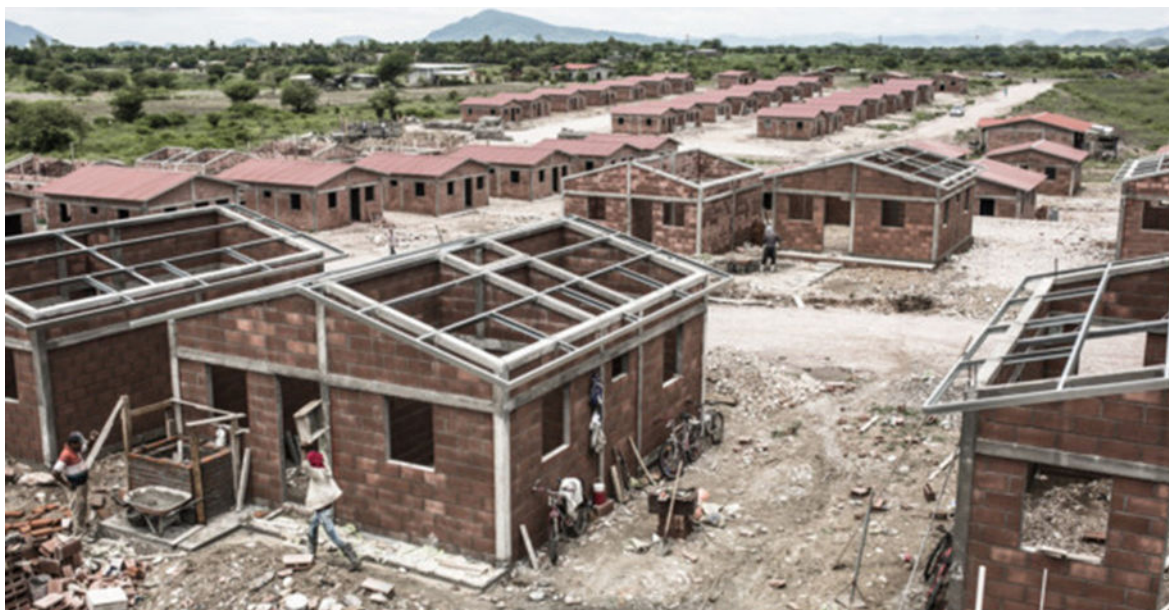
3. Viviendas en construcción en el complejo habitacional de la cooperativa de vivienda COVIMARL, en el sur de Honduras. Año 2014. Fuente: We Effect América Latina.
